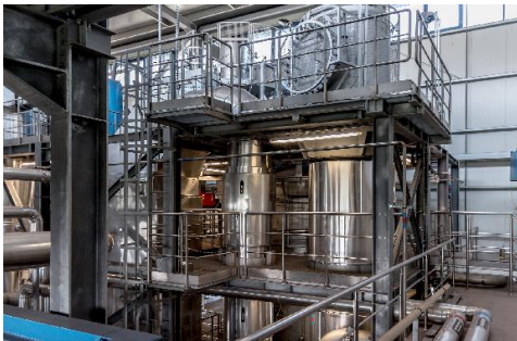
火力発電所・ごみ焼却施設
